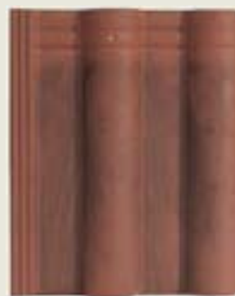
Povrch tradiční střešní tašky: silně znečištěný
